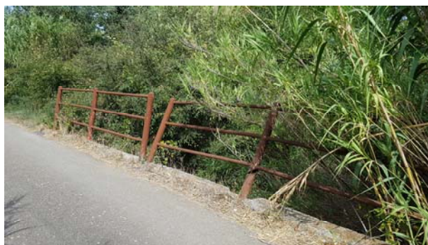
Foto 2.8.2: vista parapetti da sostituire – intervento 8
