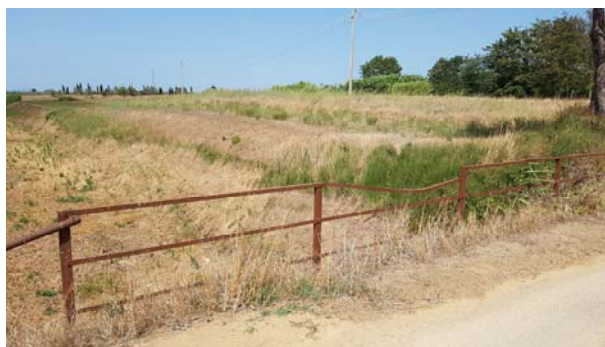
Foto 2.9.2: vista parapetti da sostituire – intervento 9
